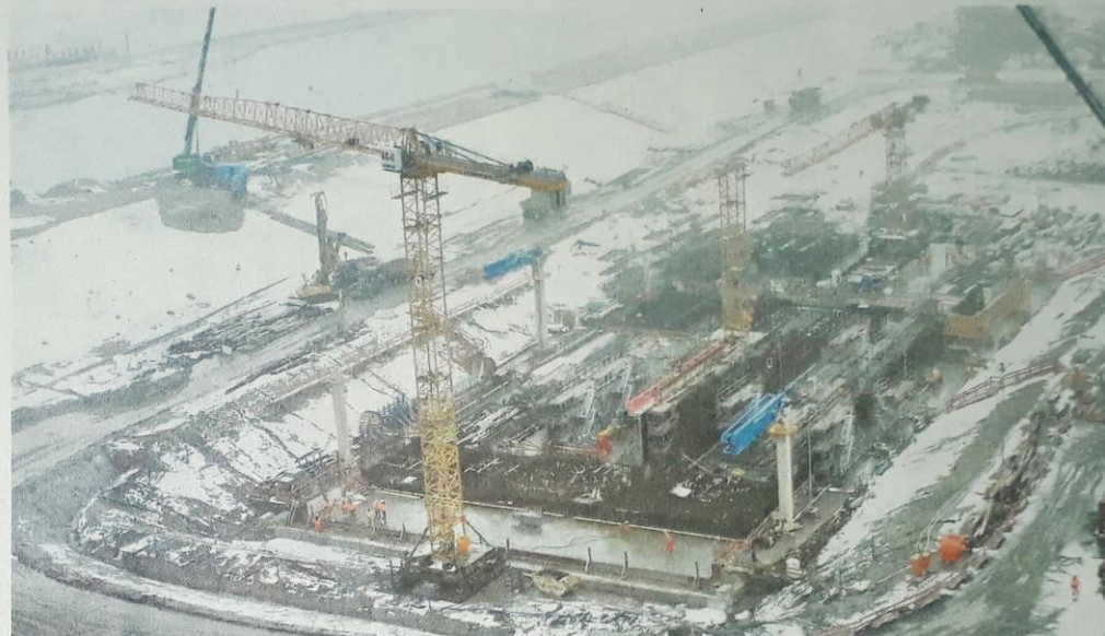
Die Baustelle des Fehmarnbelttunnels in Puttgarden. Während die Dänen an der festen Querung bauen, scheint die Finanzierung der deutschen Hinterlandanbindung in Gefahr zu sein. FOTO: FEMERN A/S
